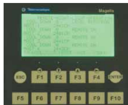
Pomocí dotykové obrazovky na stadionu Al Shamal v Qataru je možné ovládat zároveň osvětlení stadionu i vysouvání teleskopických stožárů.
