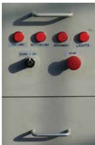
Ovládací deska na základové části stožáru.
