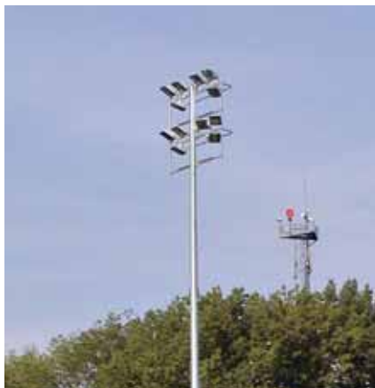
Pevný stožár s žebříkem a dvěma plošinami
