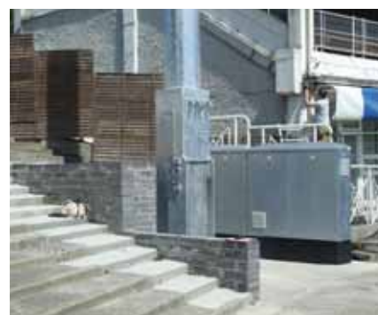
Standardní umístění rozvaděče u paty stožáru.
